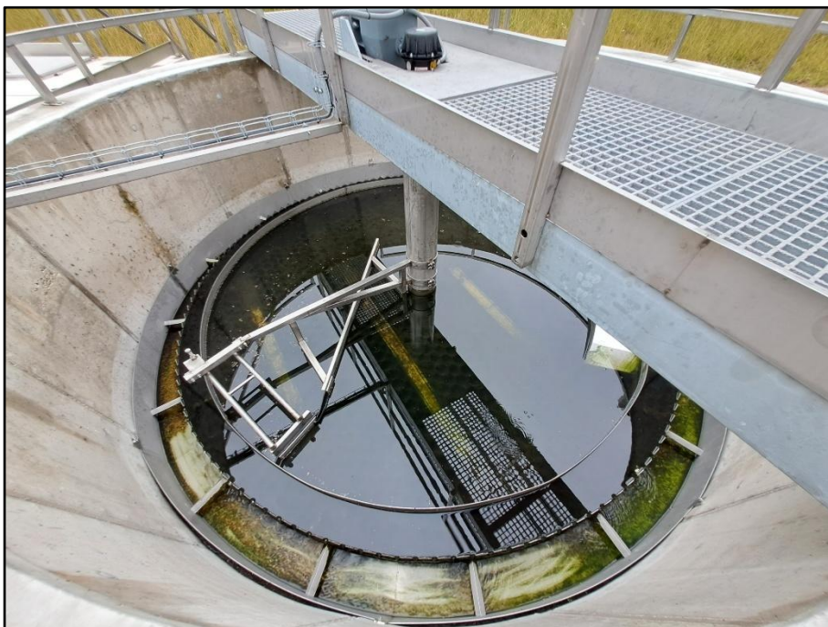
Kanalizace a ČOV Škvorec, foto: Auditní orgán
