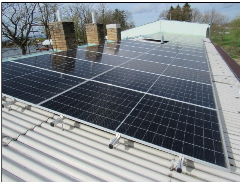
FVE na provozovně pro zpracování ryb společnosti FISH MARKET a. s., foto: Auditní orgán
