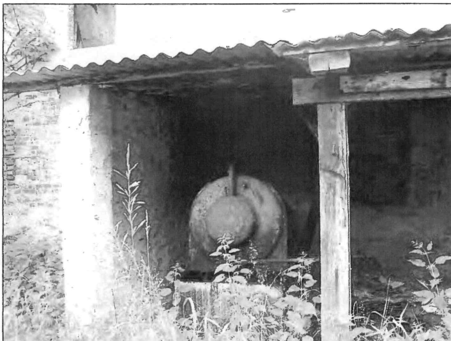
Obrázek 9: Nádrž na topnou naftu ohříváče vzduchu
