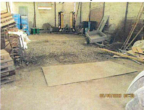
Vydrolený beton podlah
