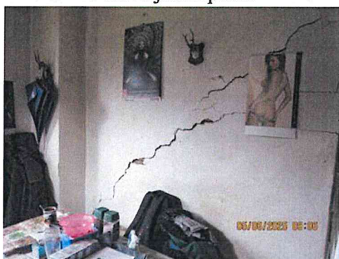
Šatna - trhliny ve zdivu
