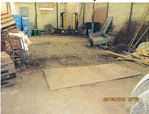
Vydrolený beton podlah
